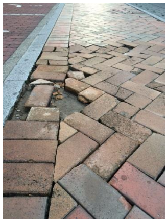
レンガが破損した コンビニ前の歩道
