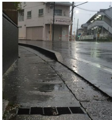
地図◆B～C 東京ベイ浦安市川医療センター近隣 蓋かけ側溝の幅の歩道 カーブになり見通しも悪い
